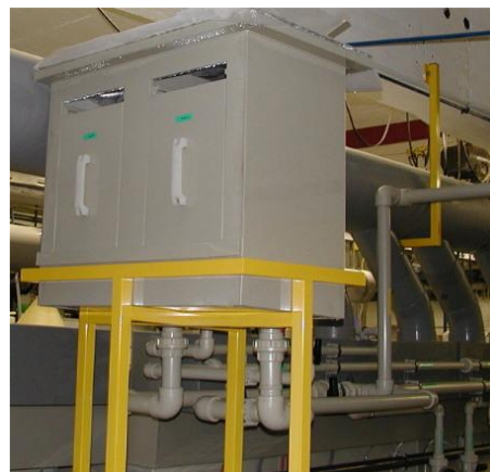
Bild 4: Filterstation mit freihängenden Filterbeuteln (Wartungstüren geschlossen), die Wartungstüren können auch transparent sein.
